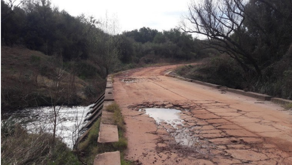
Imagen 11 Arroyos que provocan crecidas y caminos. Acceso a Rincón de Cololó.
